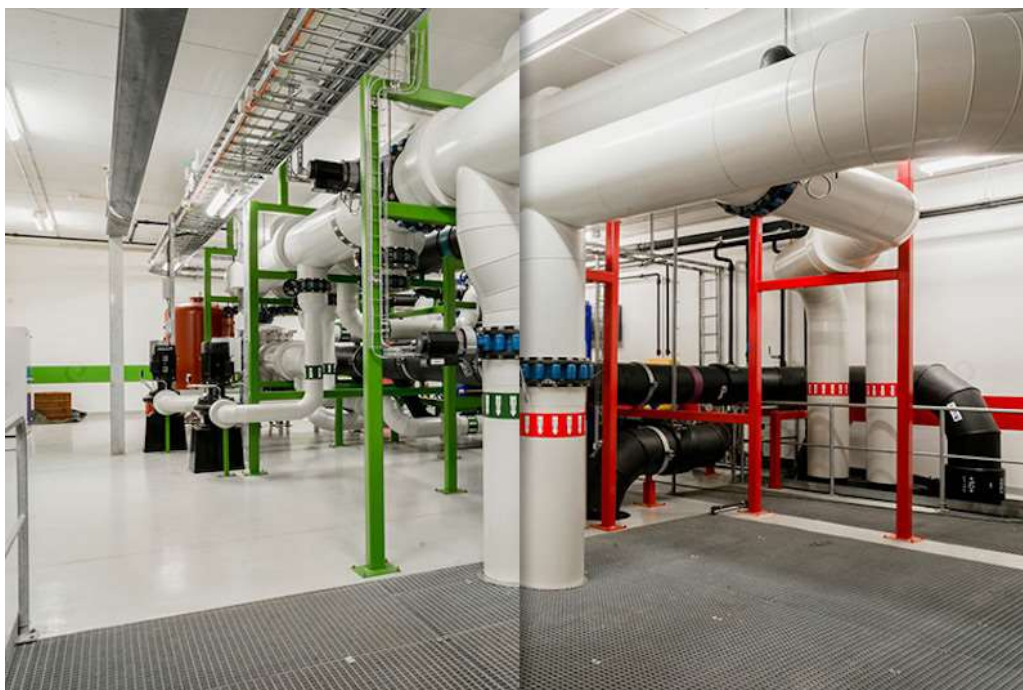
Распределительный зал системы охлаждения
