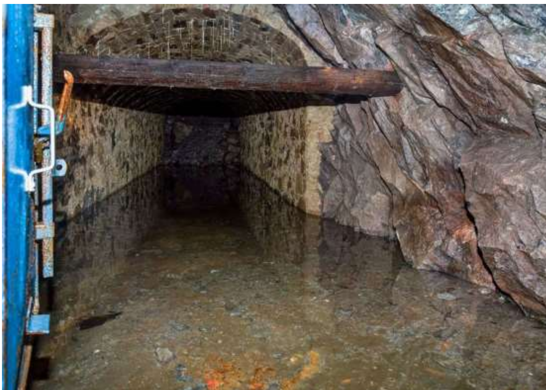
Водосборный бассейн в конце тоннеля
