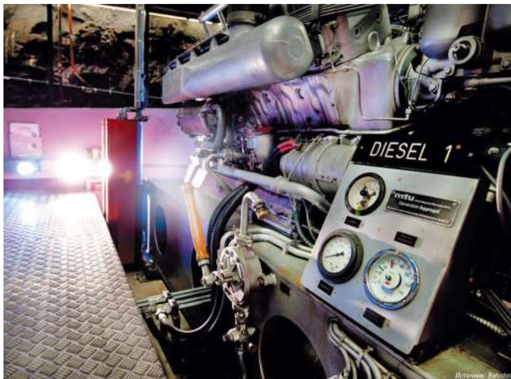
Рис. 2. Использование для ЦОДа «военных» средств резервного питания — дизельных генераторов, спроектированных для установки на подлодках
