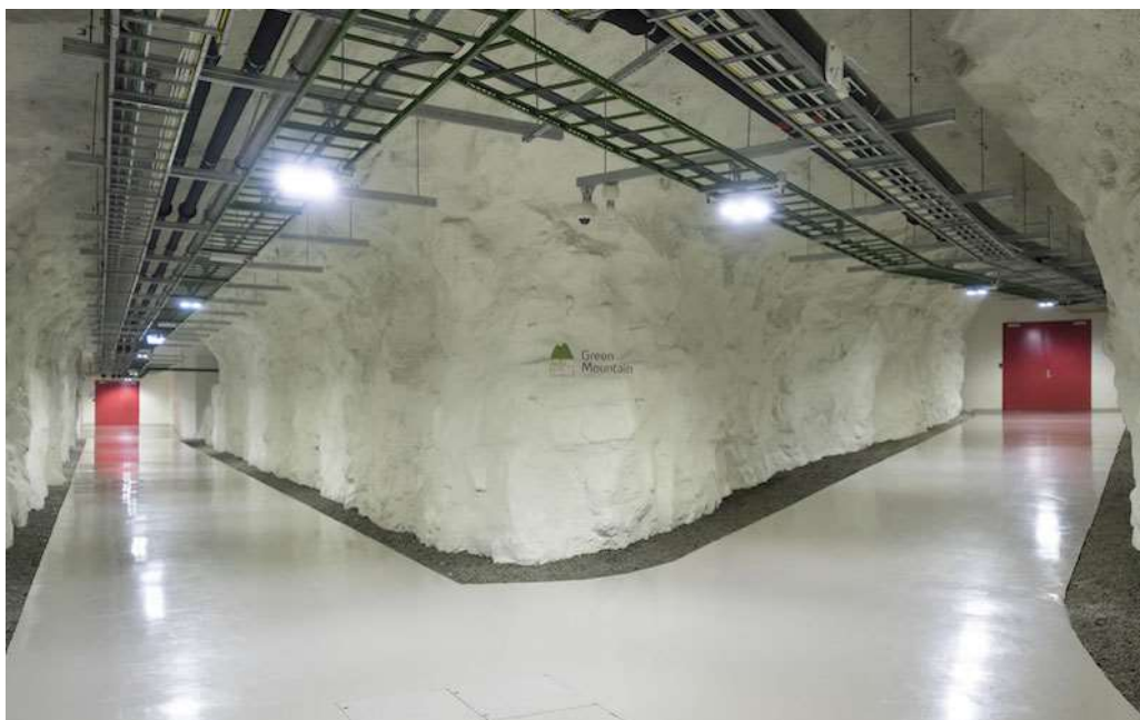
Проход к залам дата-центра
