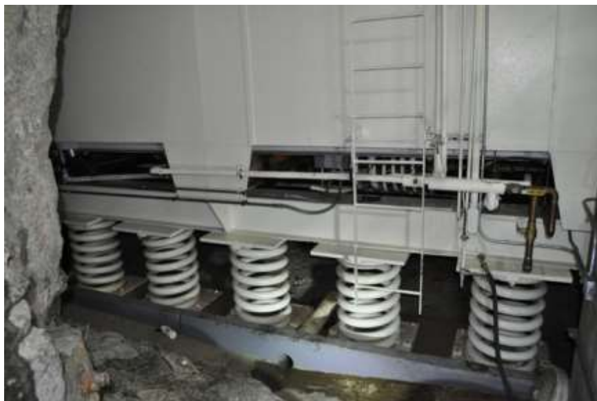
Фрагмент установки пружинных опор
